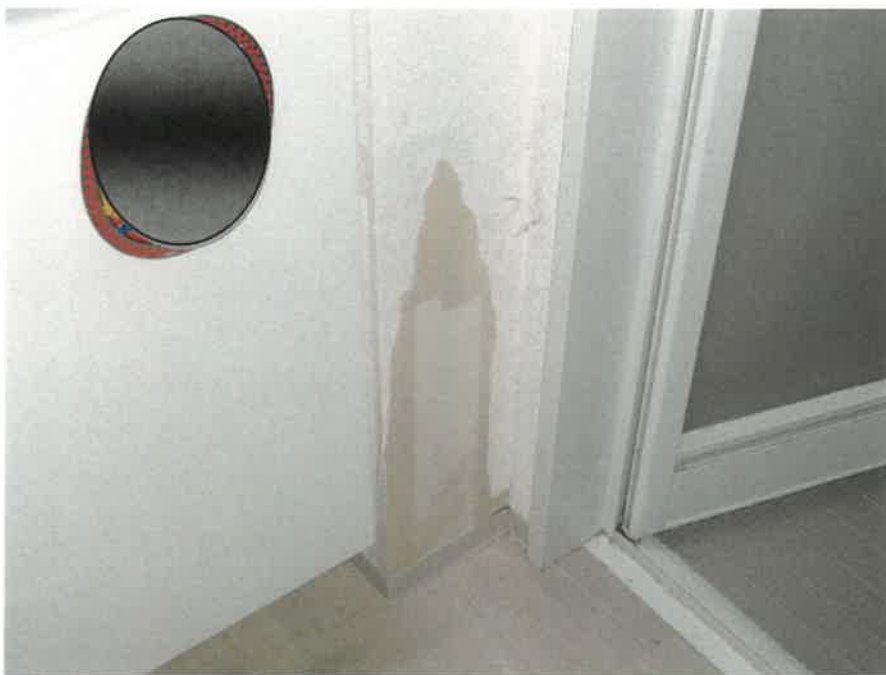
⑧ 洗面室壁紙の剥がれの状況
