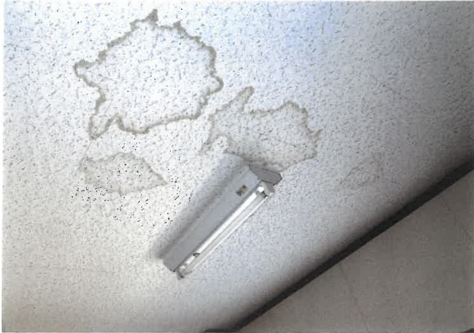
⑤ 屋内の状況（洋室2の天井の雨漏り跡の様子）
