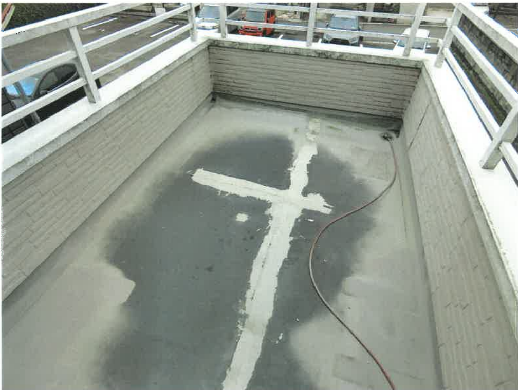
1 2 物件 2 建物のバルコニー（床材のひび割れ）
