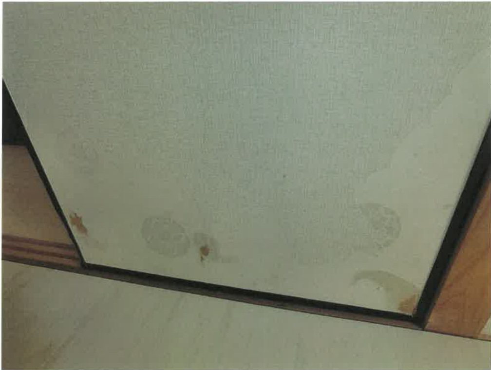
1 1 物件 2 建物内部の状況（建具の損傷・和室）
