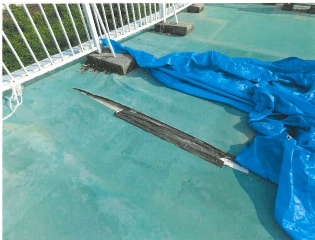
9 物件2建物屋上の状況（防水シートの劣化）
