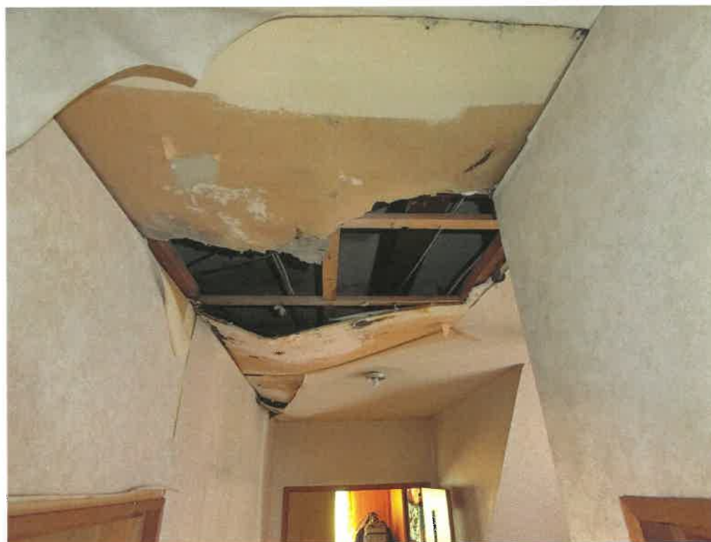
1 2 物件2建物内部の状況（雨漏りによる天井材の脱落・2階廊下）
