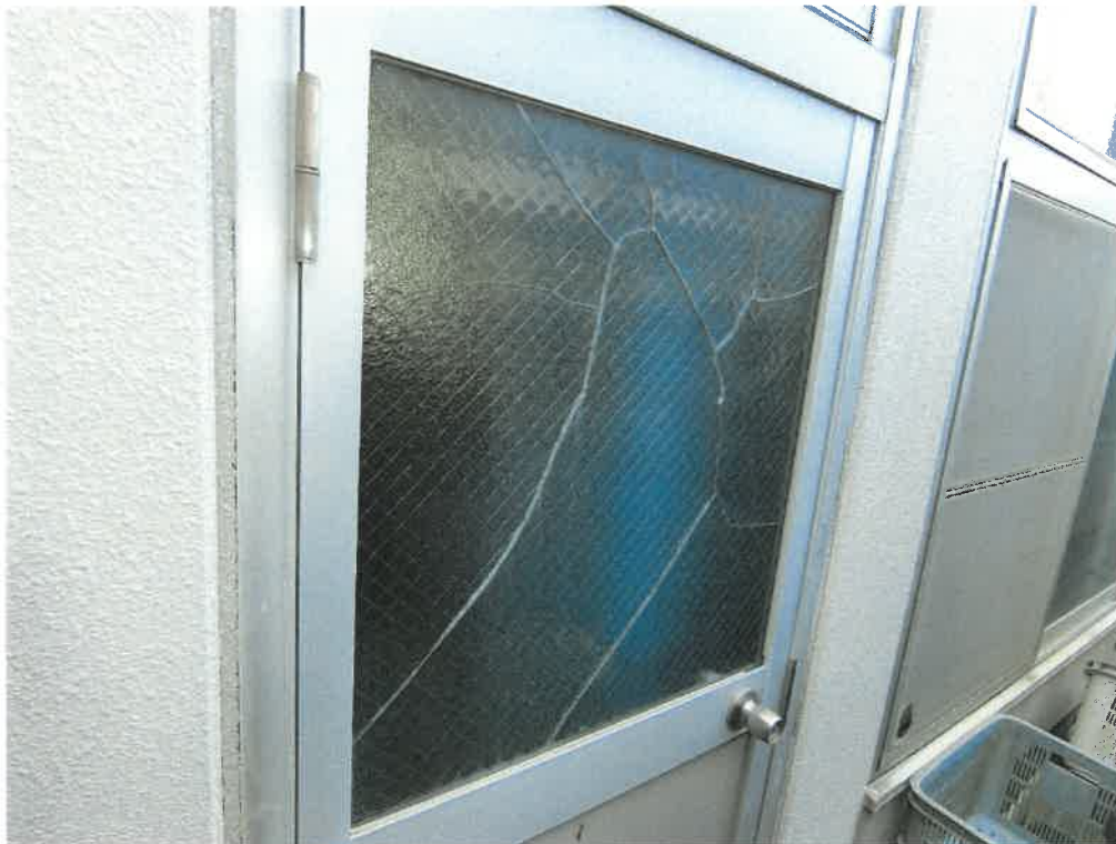
1 4 物件2建物内部の状況（網入りガラスの損傷・作業所南側）
