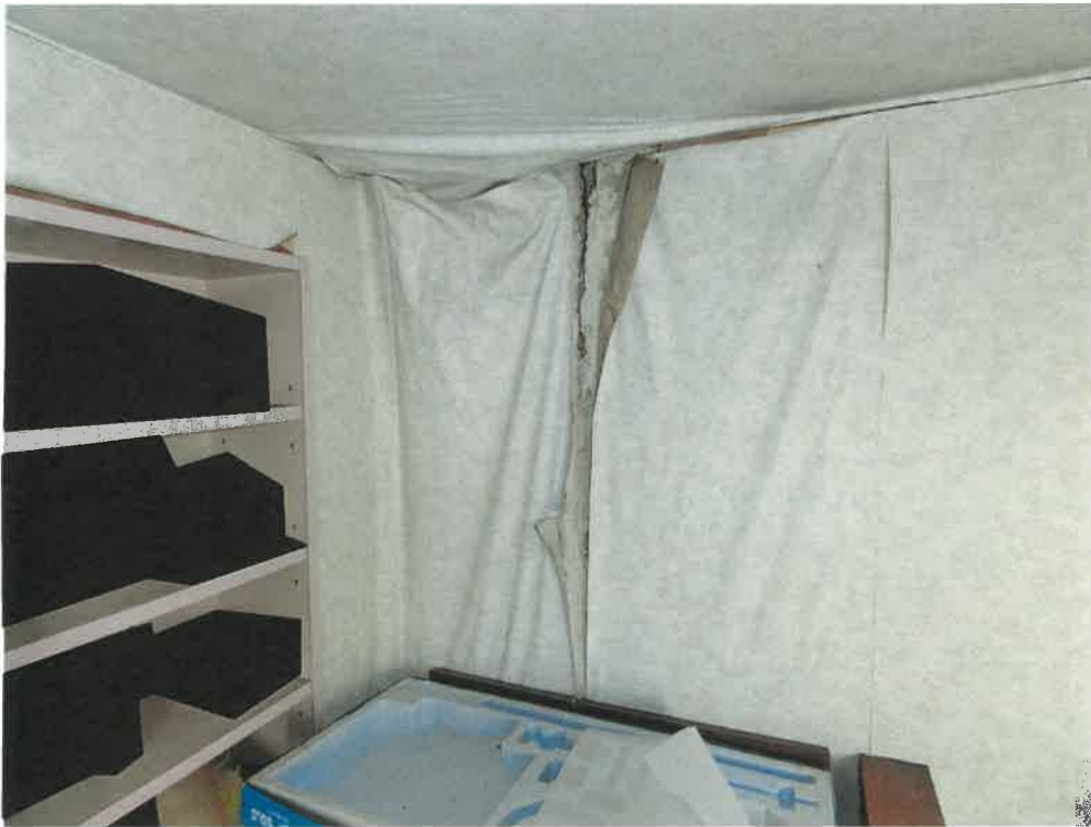
1 3 物件2建物内部の状況（雨漏りによるクロスの剥がれ・3階北角）
