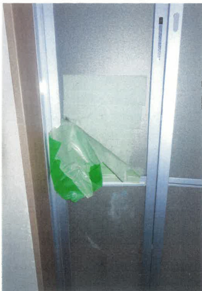
⑧ 扉の損傷状況（浴室）
