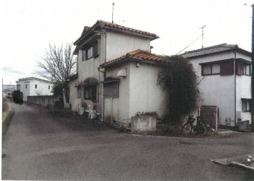
⑩ 本件建物北側の樋、庇、樹木が越境している様子
