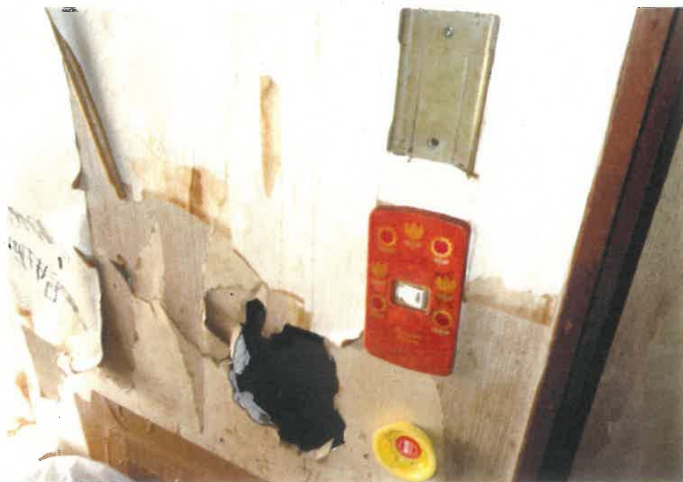
⑤ 屋内の状況（洋室①の壁に穴が開いている様子）
