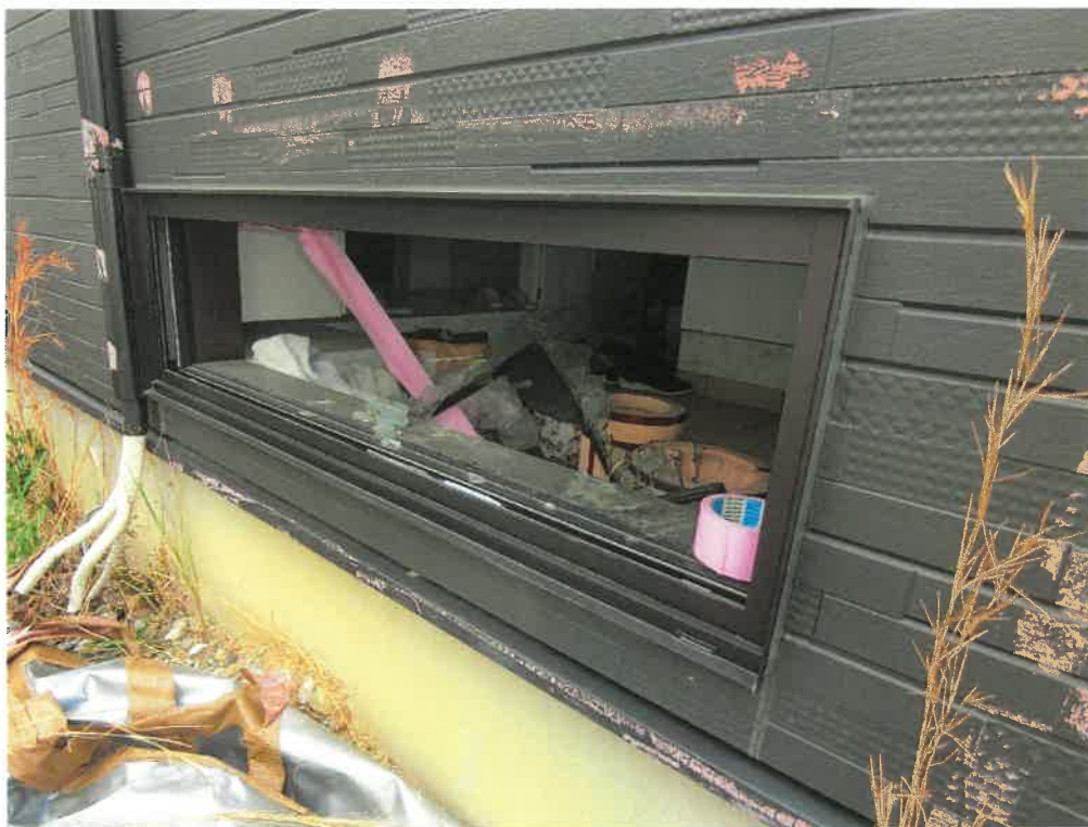
8 物件1建物内部の状況（窓ガラスの損傷（玄関東側））
