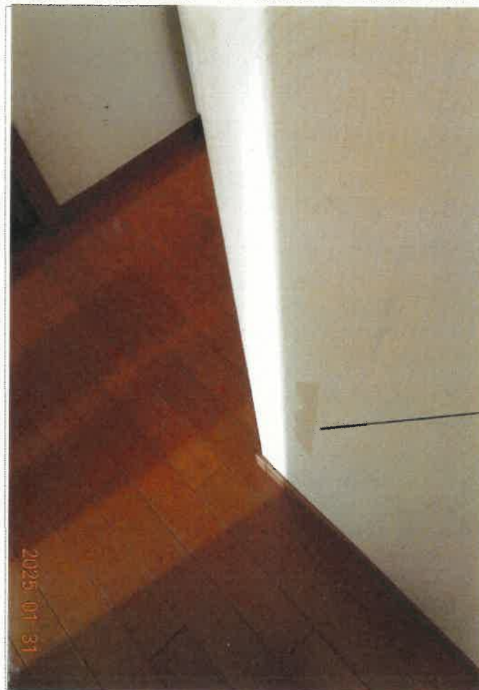
⑧ 屋内の状況（2階 廊下内壁の損傷）
