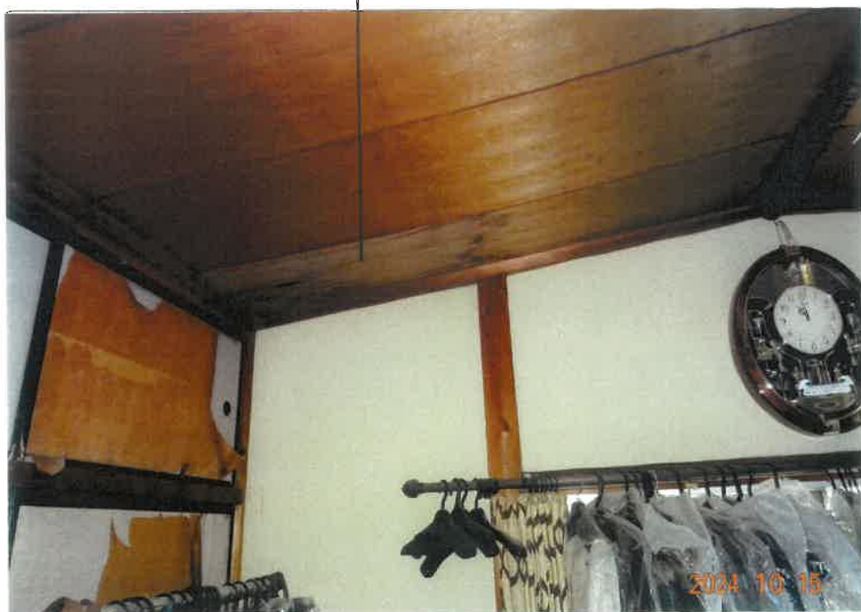
⑪ 物件4建物の屋内の状況（2階 和室2の天井の雨漏り跡）
