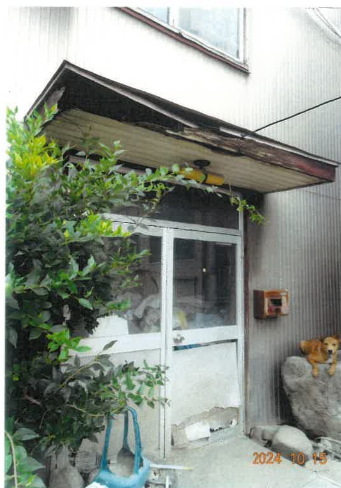
④ 物件 4 建物の 1 階出入口底の損傷状況
