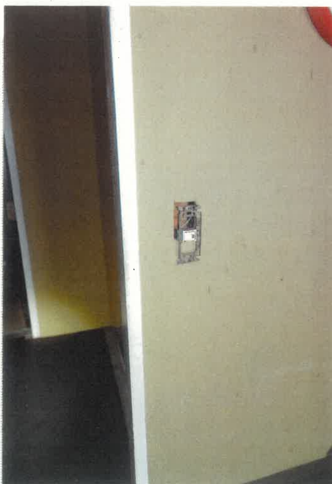
⑩ スイッチ類の破損状況（リビング・ダイニング・キッチン）
