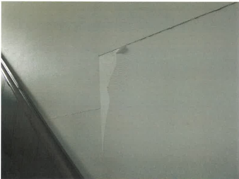
1 4 物件4建物内部の状況（クロスの剥がれ（階段））
