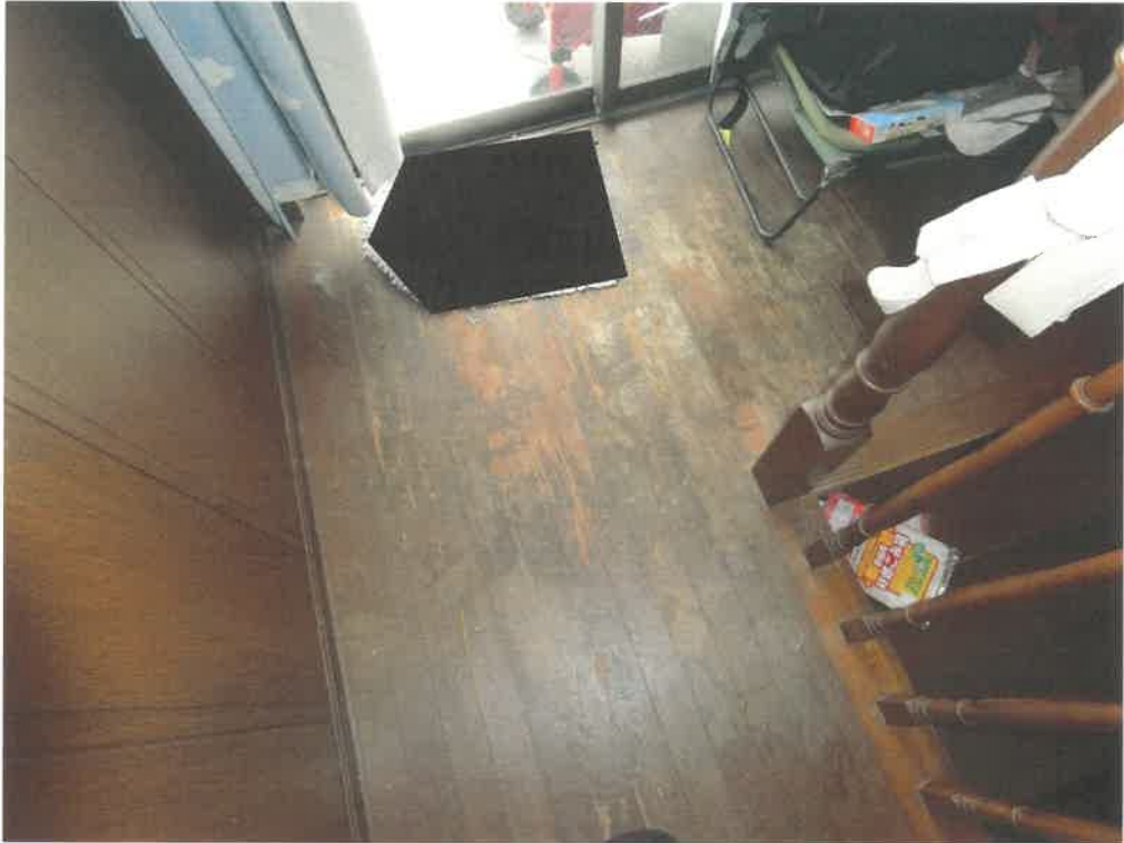
1 5 物件4建物内部の状況（床材の擦れ（2階廊下南部））
