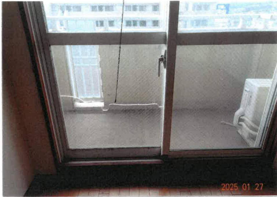
⑦ 屋内の状況（洋間2の南側窓ガラスのひび割れ）
