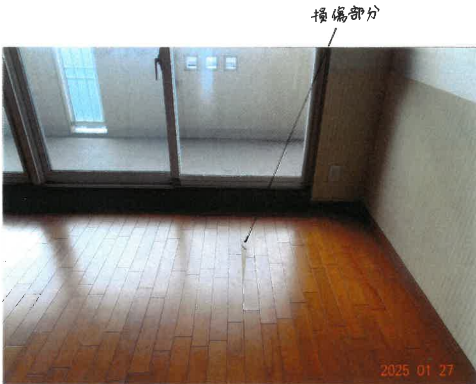
⑥ 屋内の状況（居間の床面の損傷）
