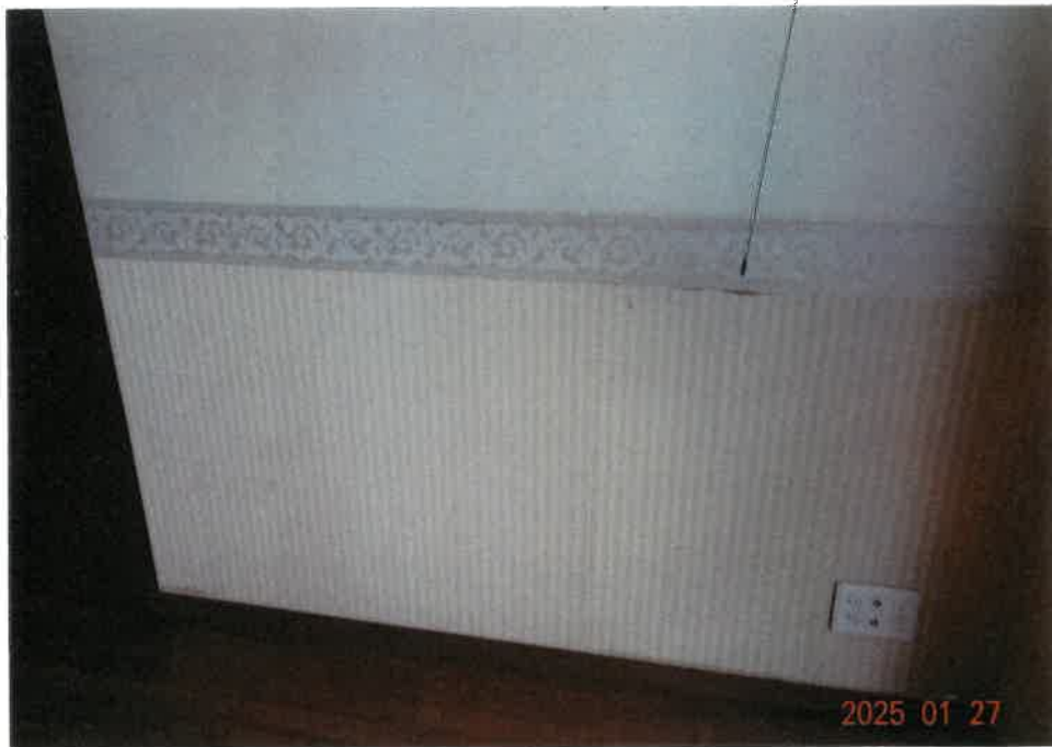
⑧ 屋内の状況（居間の東側壁のクロスの剥離）
