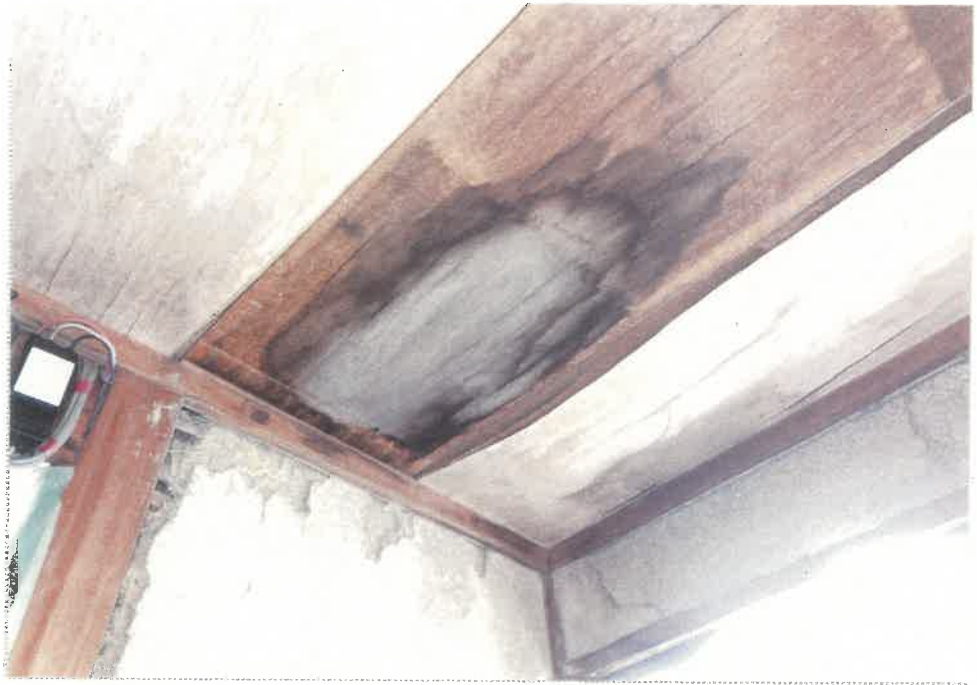
⑦ 雨漏り跡・壁面の損壊状況（玄関）
