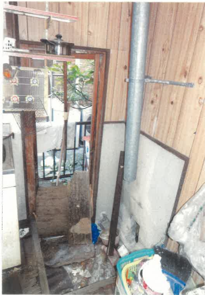
⑧ 扉の損壊状況（ダイニング・キッチンの勝手口）
