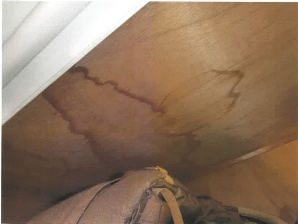
6 物件1 建物内部の状況 (クローゼット上部の染み (洋室1))
