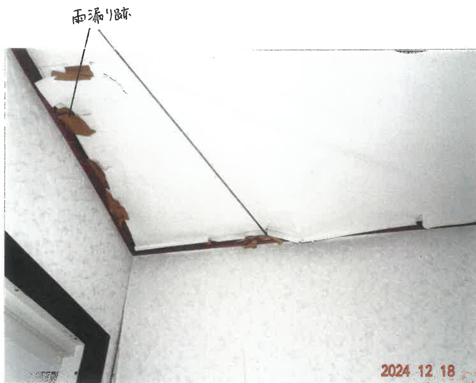
⑤ 屋内の状況（1階 洗面脱衣室天井の雨漏り跡）
