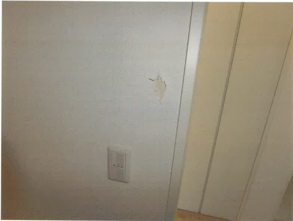
6 物件2建物内部の状況（クロスの損傷・洋室2）
