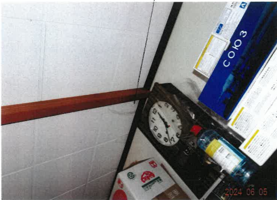
⑧ 物件2建物主である建物屋内の状況（1階 事務所の雨漏り跡）
