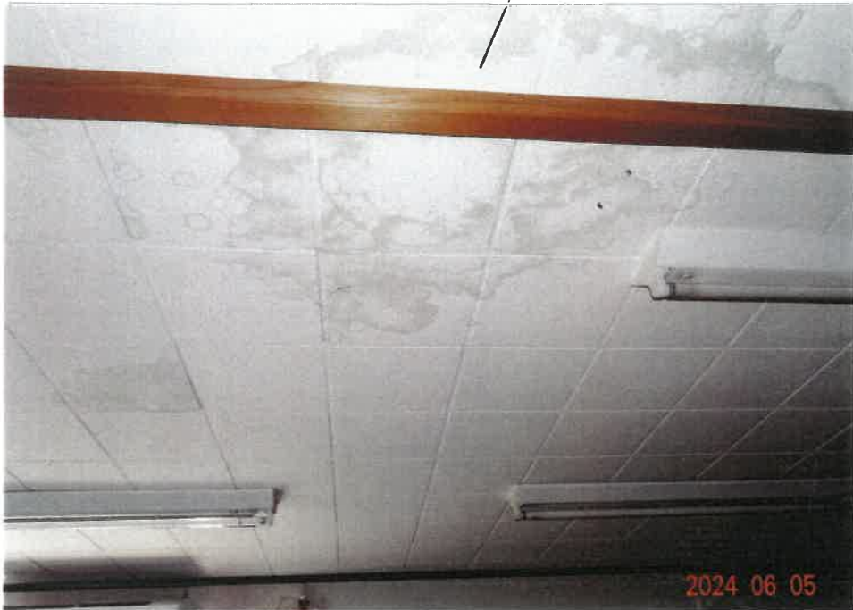
⑦ 物件2建物主である建物屋内の状況（1階 事務所の雨漏り跡）
