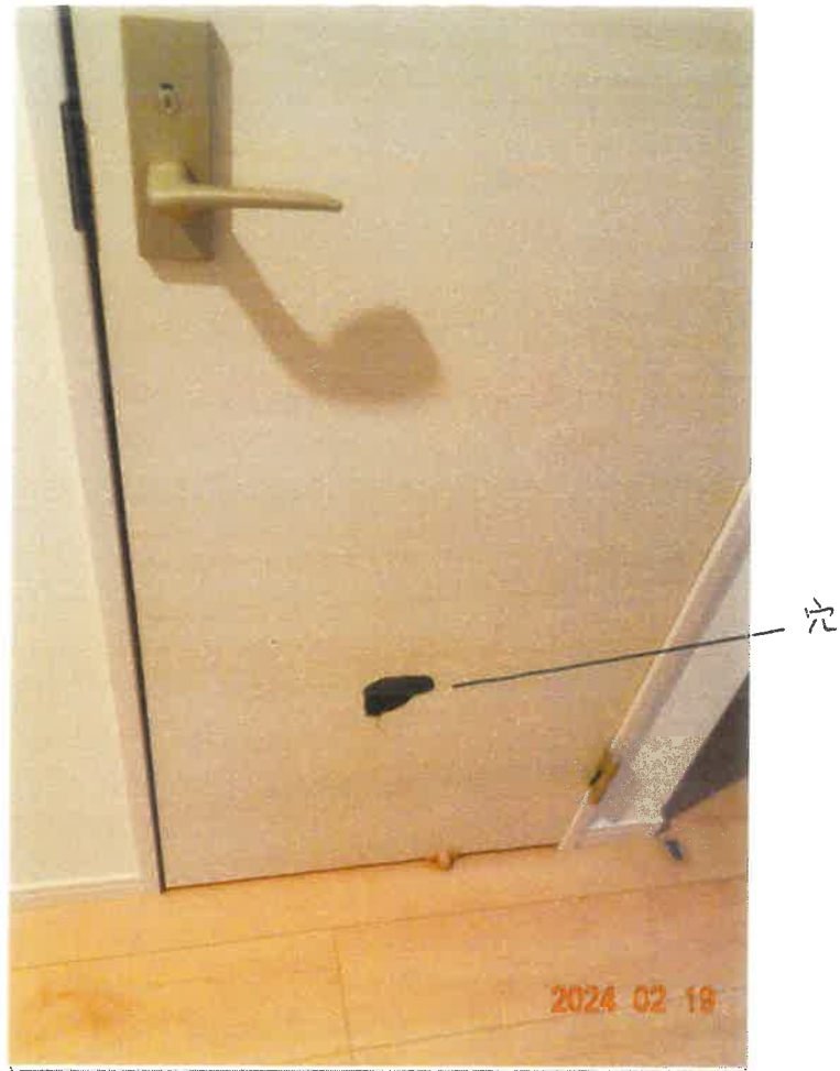
⑦ 屋内の状況（2階 トイレの扉の穴）
