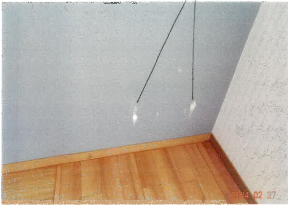
⑦ 屋内の状況（2階 洋室 1壁のクロス損傷部分）
