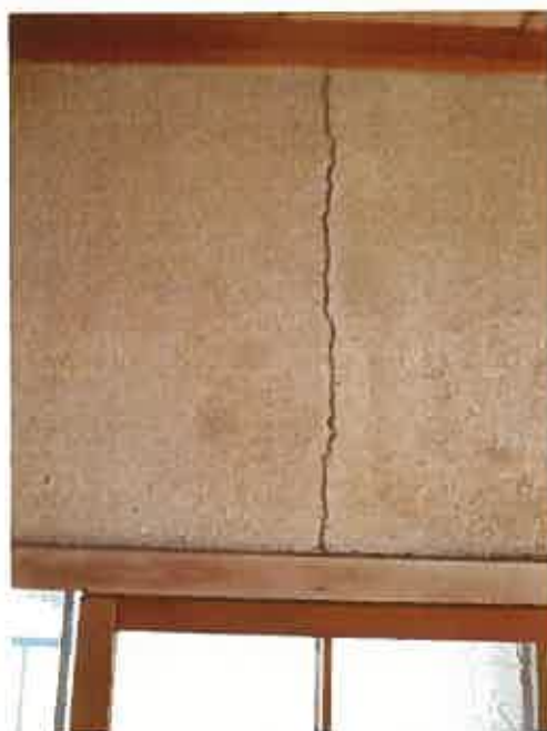
20 同上 壁の ひび割れ
