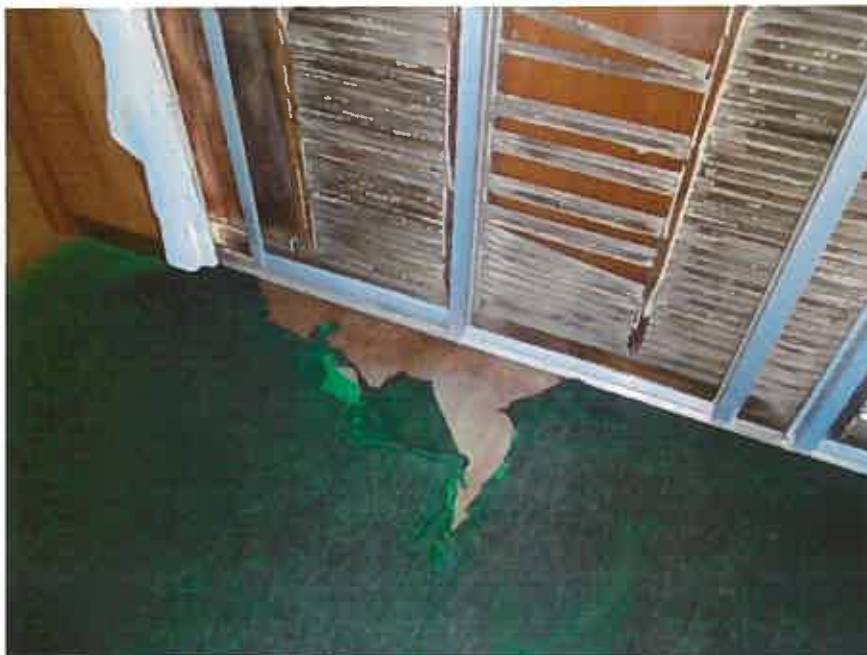
17 同上 雨戸と 床の損傷
