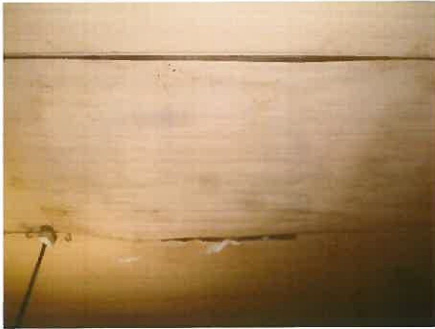
7 同上 雨漏り跡
