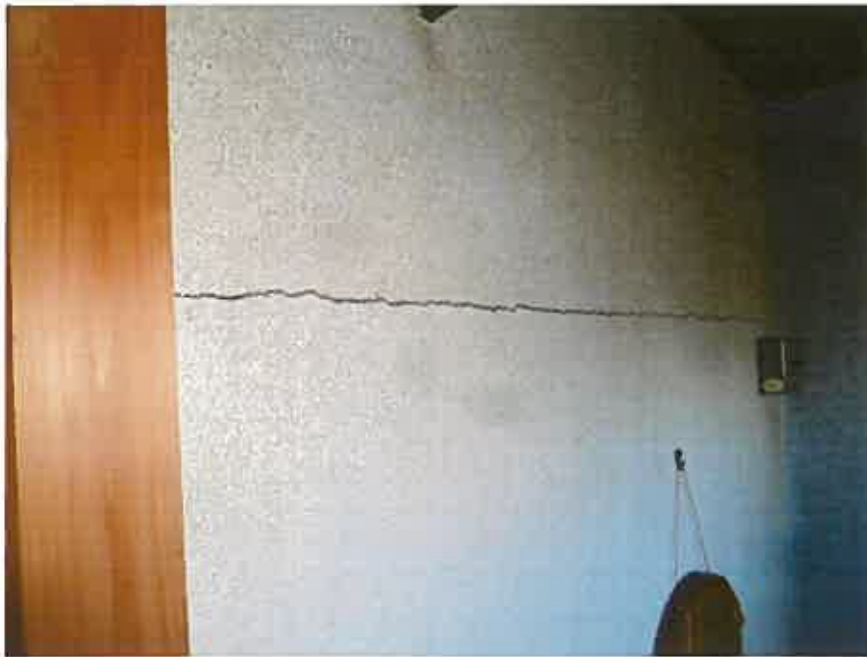
4 同上 壁の ひび割れ
