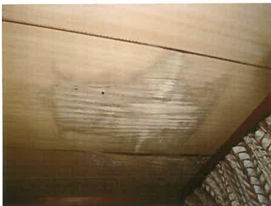
21 2F 廊下 雨漏り跡
