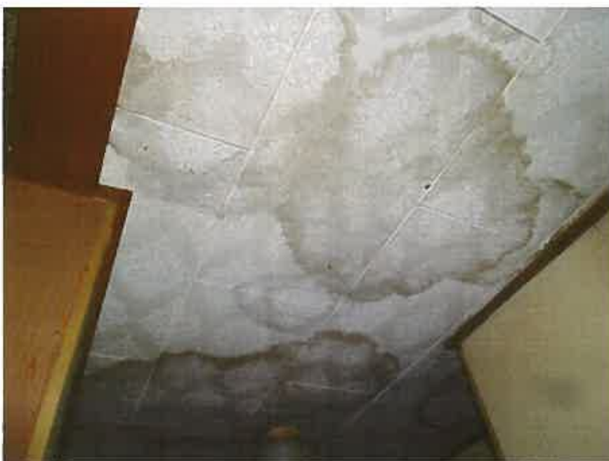
11 廊下の 天井の 雨漏り跡
