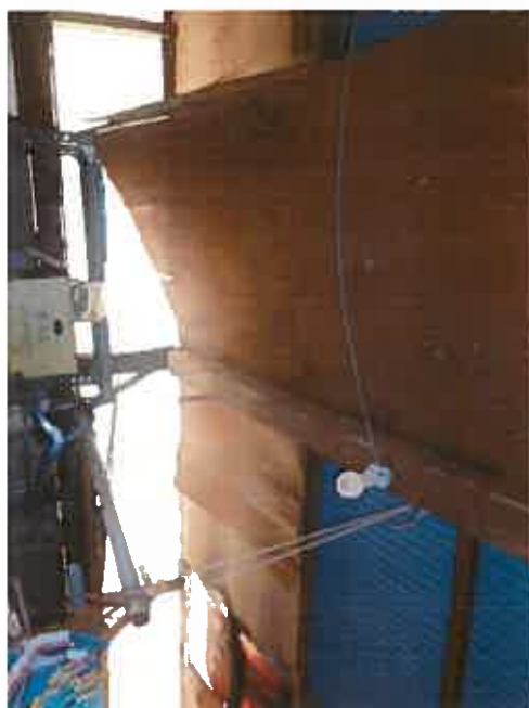
15 同上 壁が一部 剥がれて いる状況
