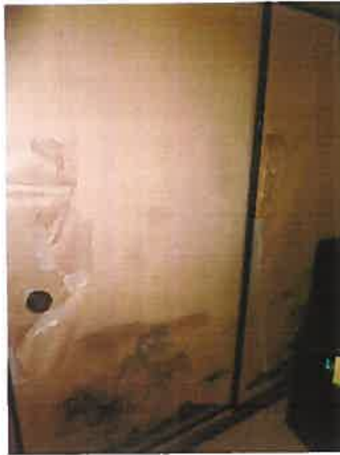
13 同上 襖の損傷
