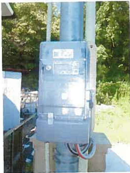
5 支柱に 付けられた 電気メーター
