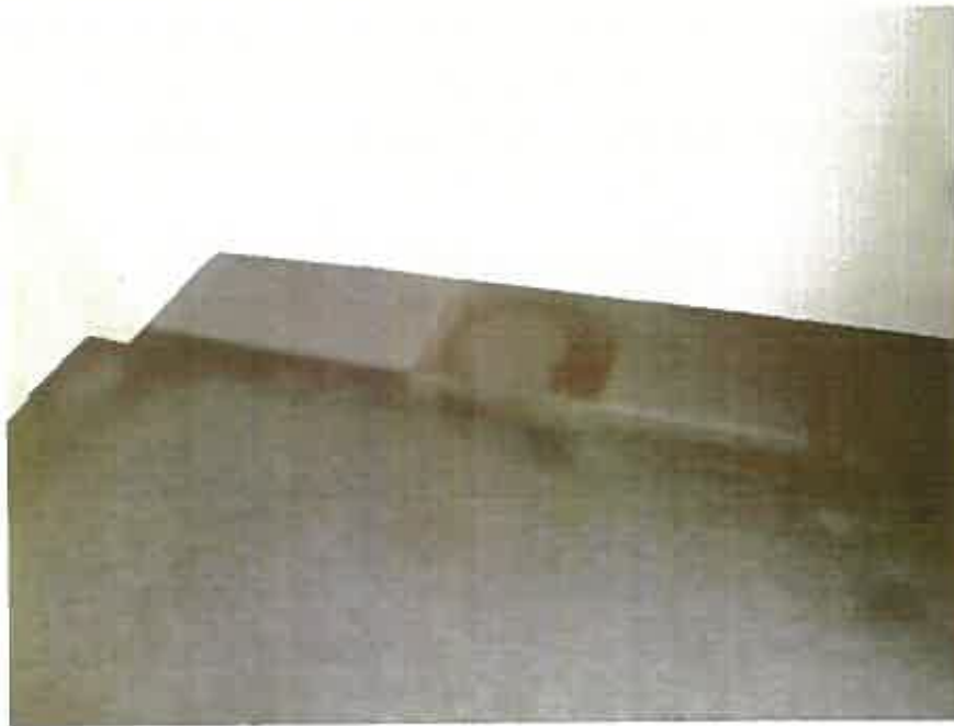
13 同上 床の汚れ
