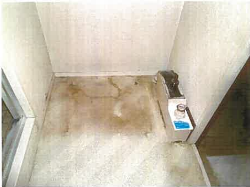
8 同上 床の汚れ
