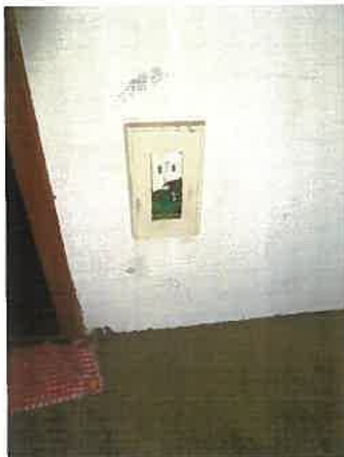
6 同上 コンセント の破損
