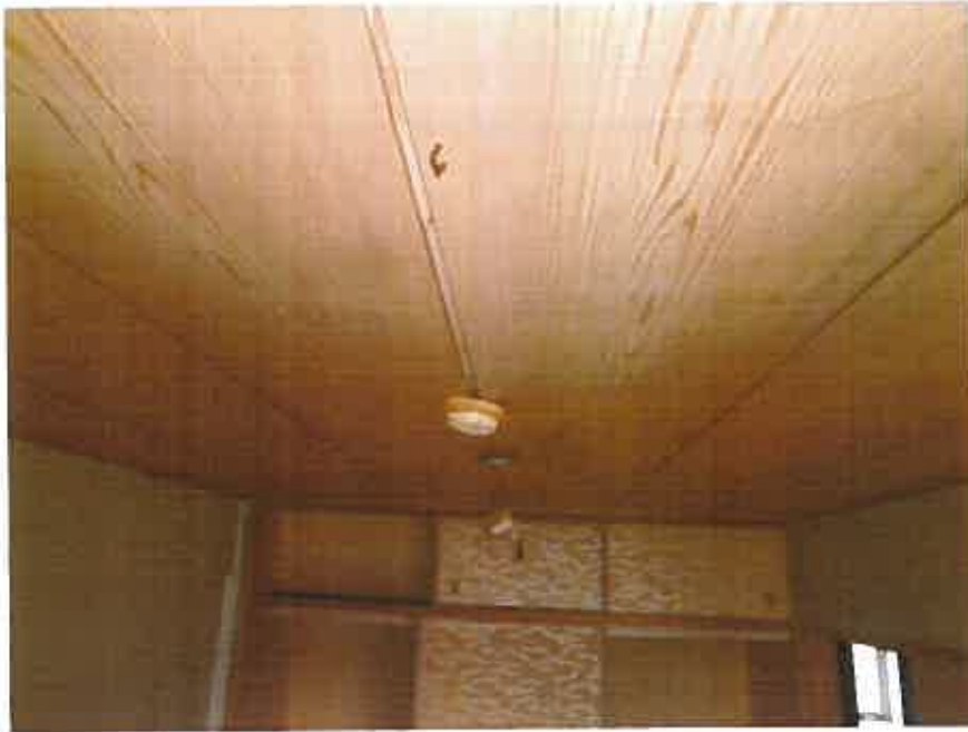
16 同上 天井板 の弛み
