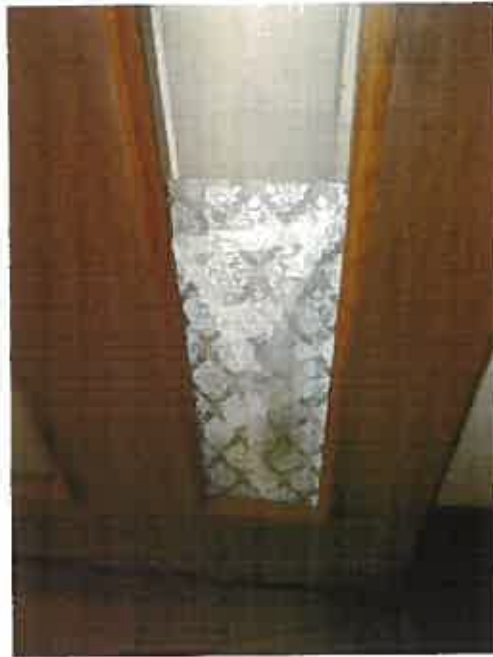
10 リビングの ドア補修跡
