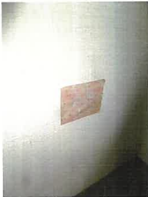
5 同上 壁の補修跡
