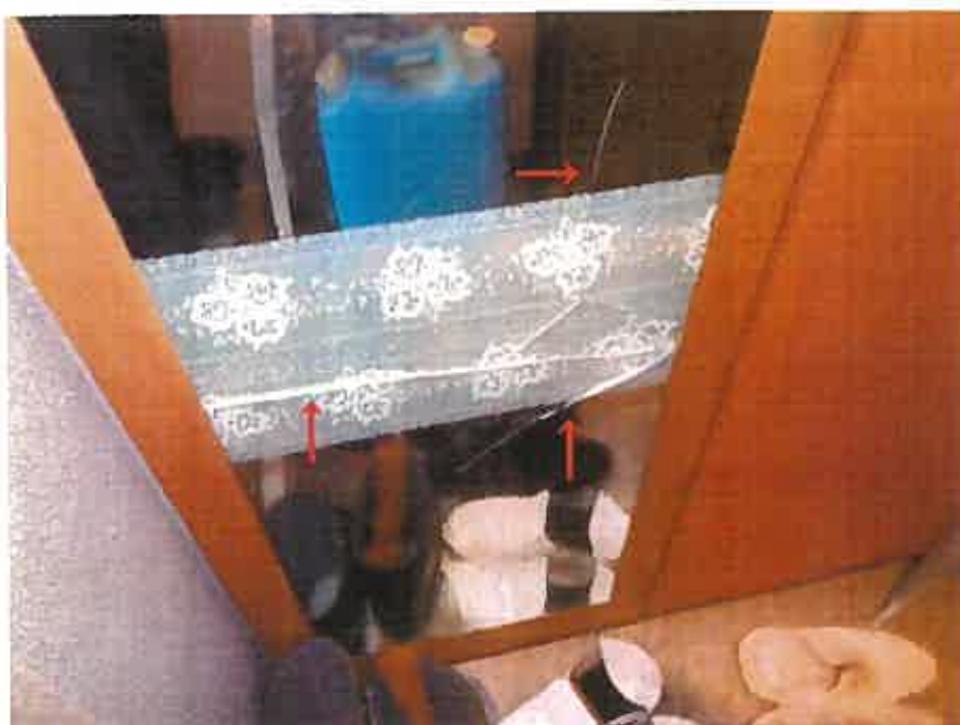
3 ガラスの亀裂
