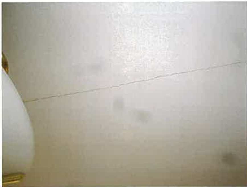
14 同上 天井の ひび割れ
