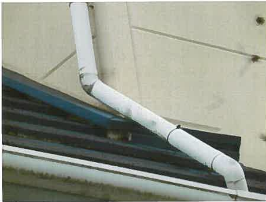
2 玄関 ポーチ の屋根 損傷
