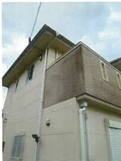
3 ベランダの 壁の汚れ
