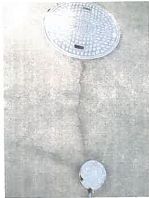
2 駐車場 ひび割れ
