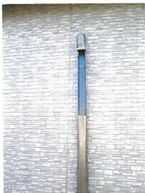
2 配管カバー のずれ
