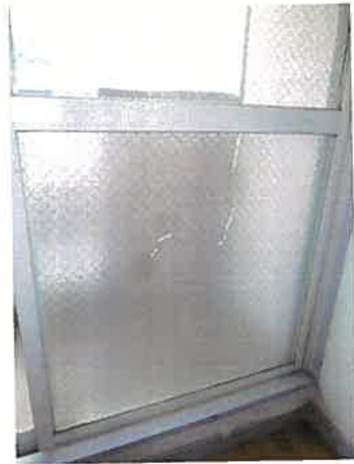
28 同上 窓のヒビ割れ
