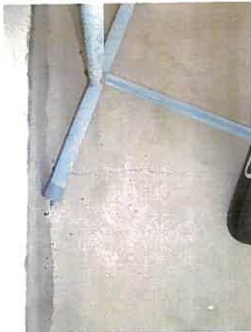
12 同上 バルコニー のひび割れ
