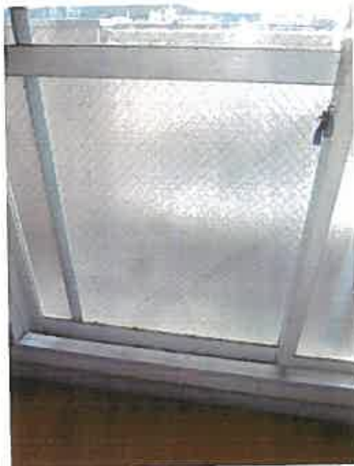
33 同上 窓のヒビ割れ
