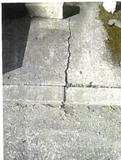
3 犬走りの ひび割れ
