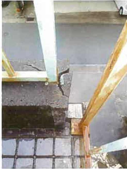
13 同上 ひび割れ
