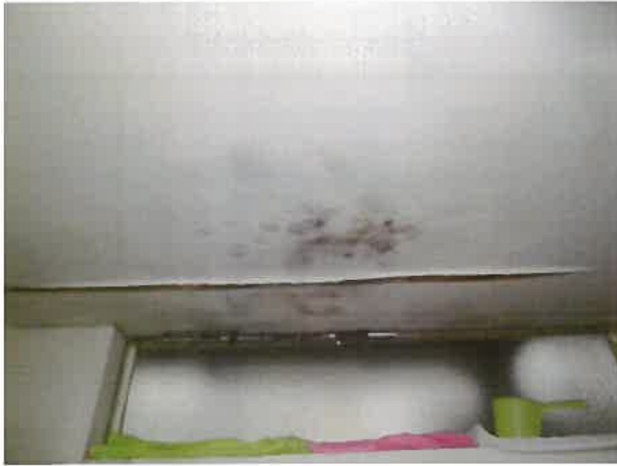
10 脱衣所 雨漏り跡
