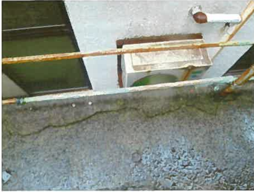
25 同上 ひび割れ
