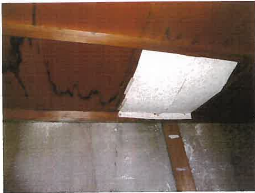
16 同上 雨漏り跡
