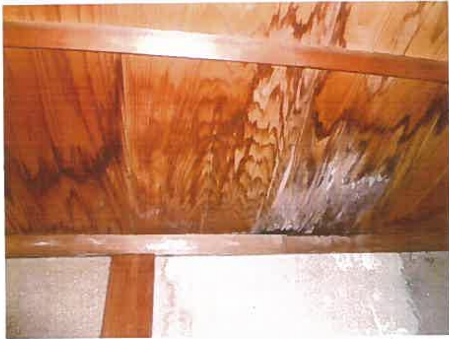
19 同上 雨漏り跡
