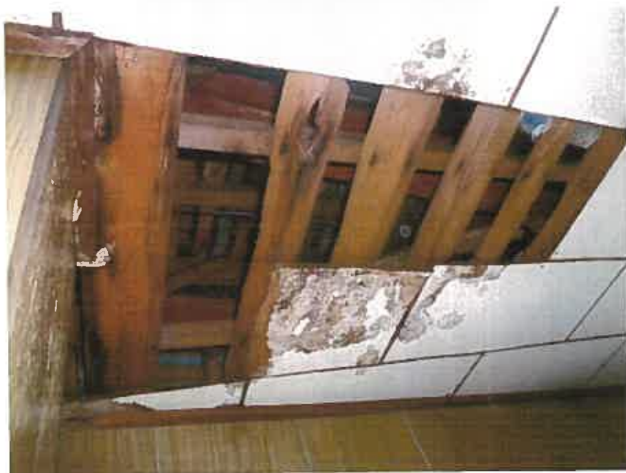
21 同上 天井の 損傷
