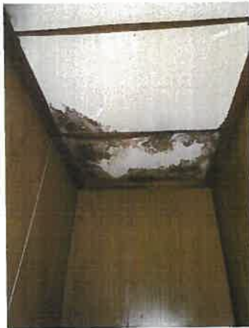
17 板間1 雨漏り跡
