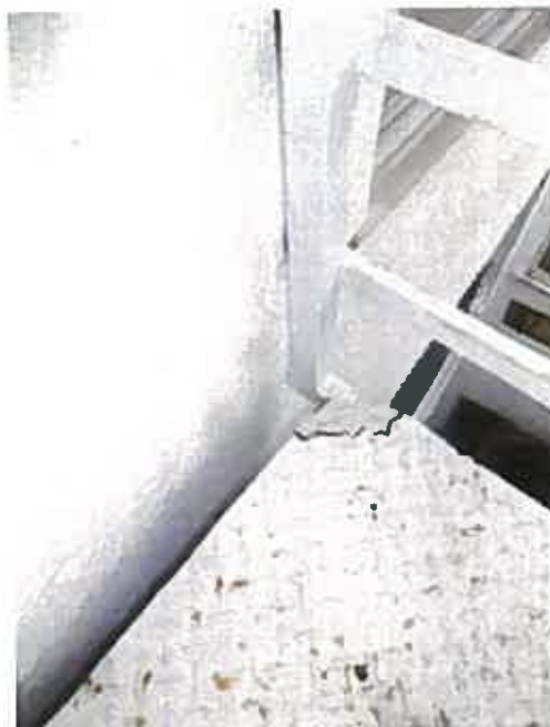
24 外階段の ひび割れ
