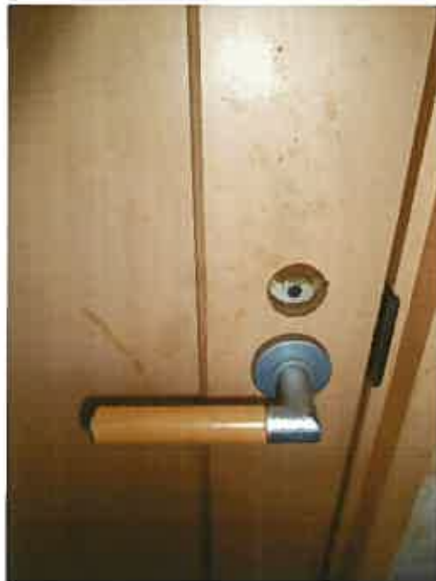
5 1F トイレの 鍵がない 状況
