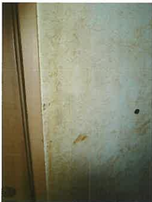
6 1F 廊下の 壁の汚れ
