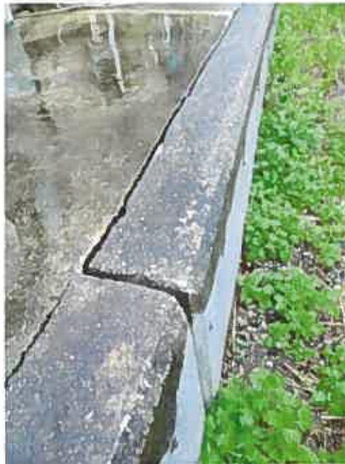
2 擁壁の ひび割れ
