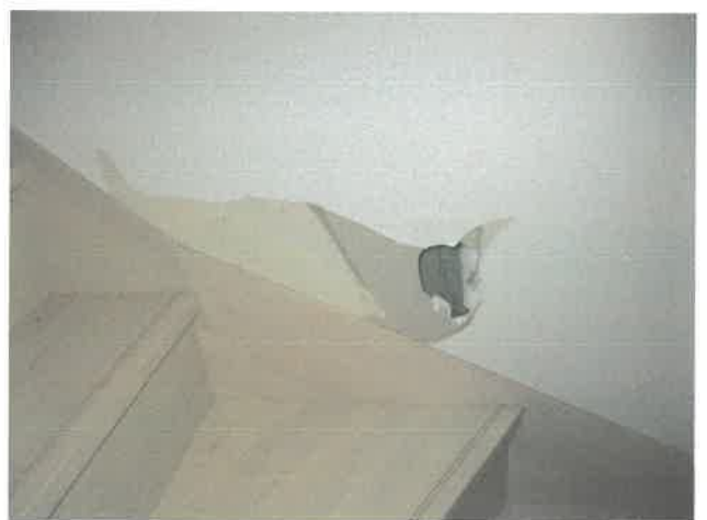
階段壁面の損傷
