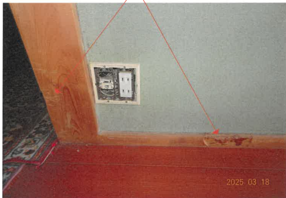
⑨ (物件3 2階ホール柱 損傷箇所)
