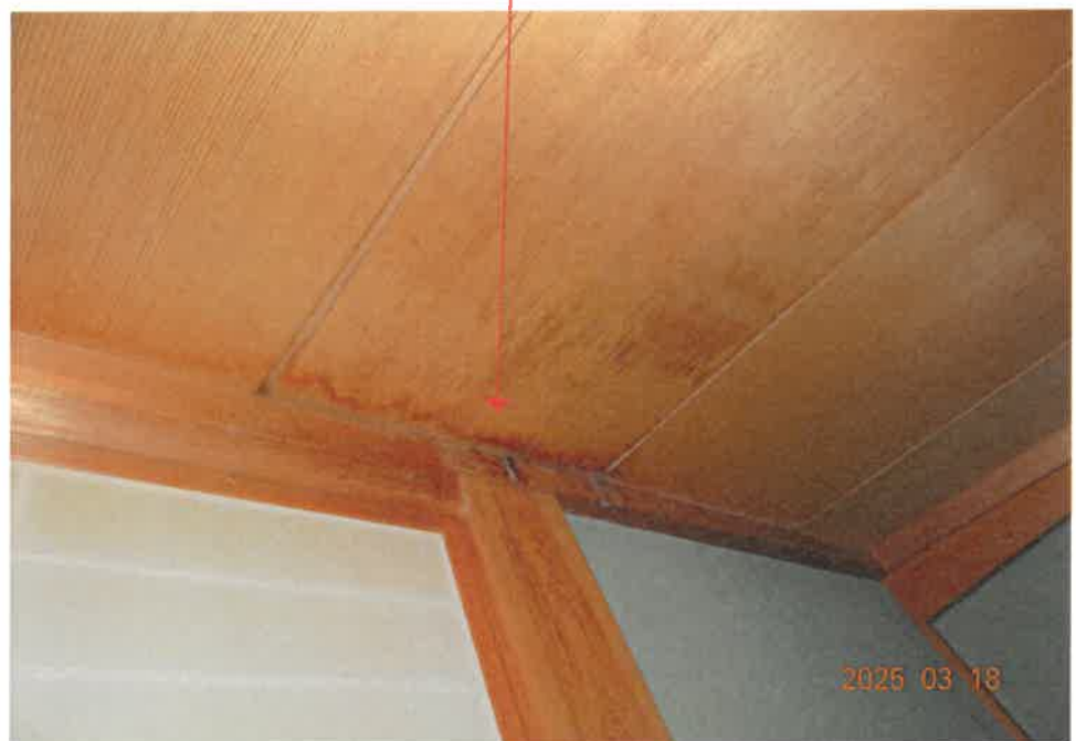
⑦ (物件3 1階廊下 天井雨漏り跡)
