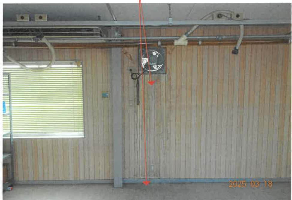
⑫ (物件4 作業場の壁・床 損傷箇所)
