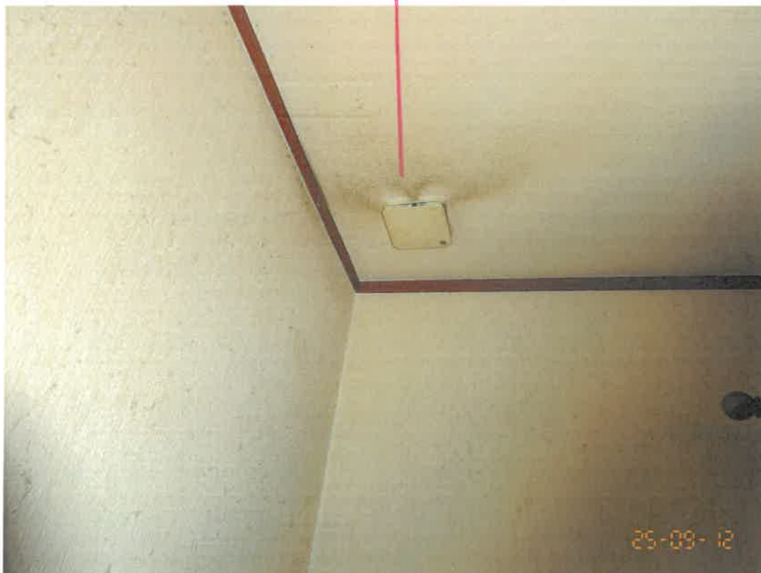
換気口付近の汚れ
