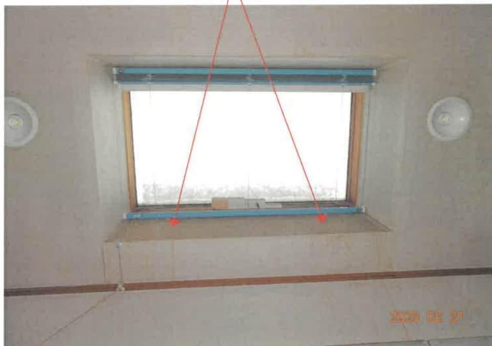
⑪ (物件4 キッチンの天窓周辺 雨漏り跡)
