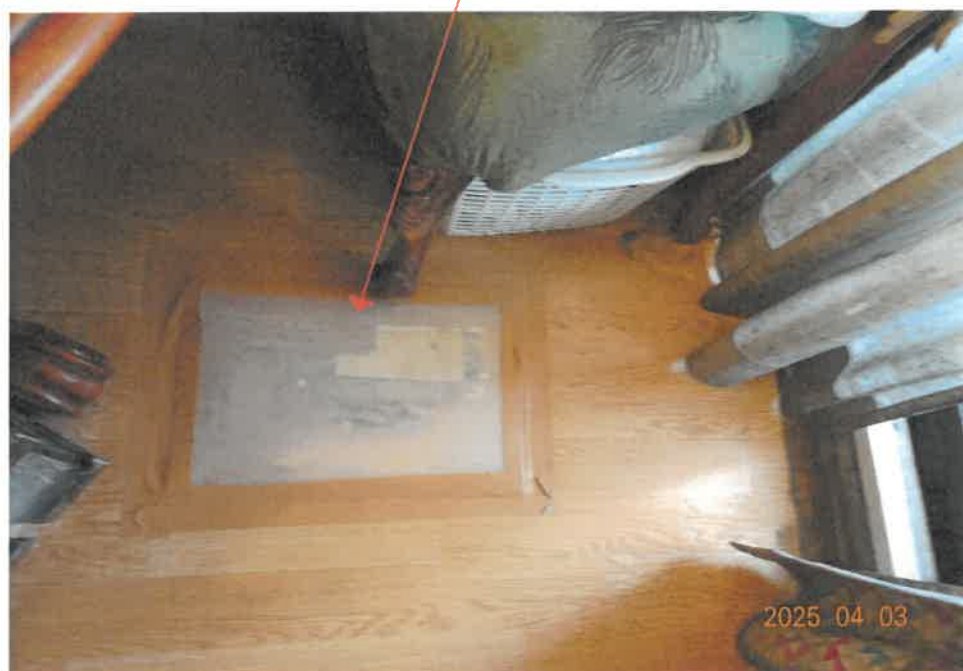
⑦ (LDK クッションフロア 損傷箇所)
