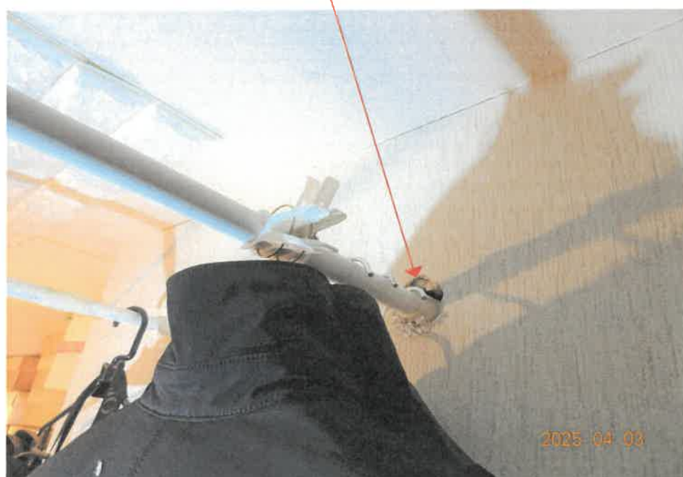
⑧ (玄関付近 壁 穴開き箇所)
