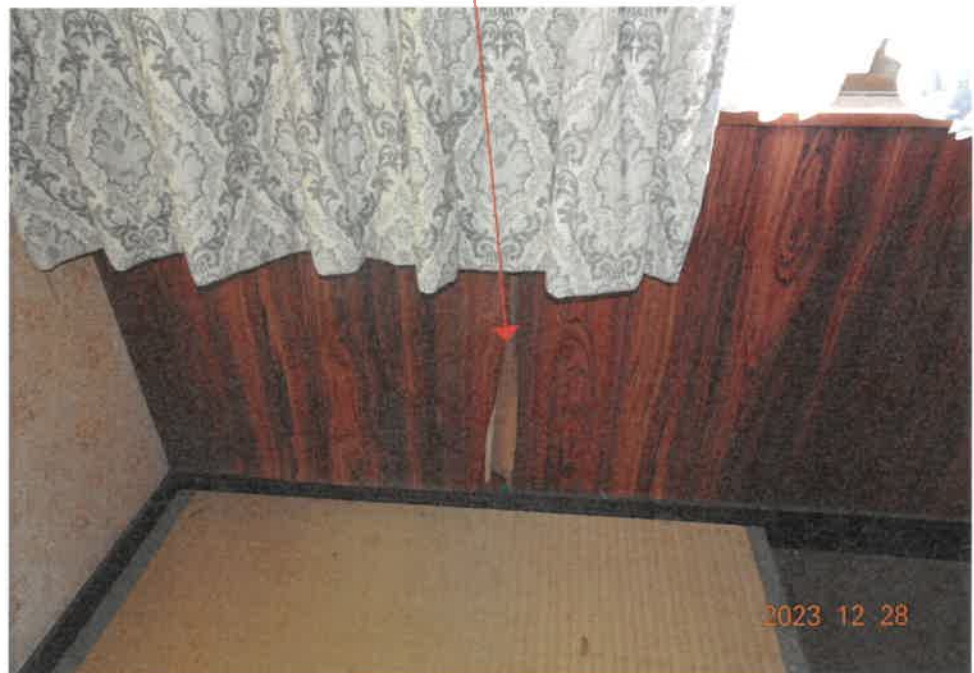
⑪ (1階南東側洋室 損傷箇所)
