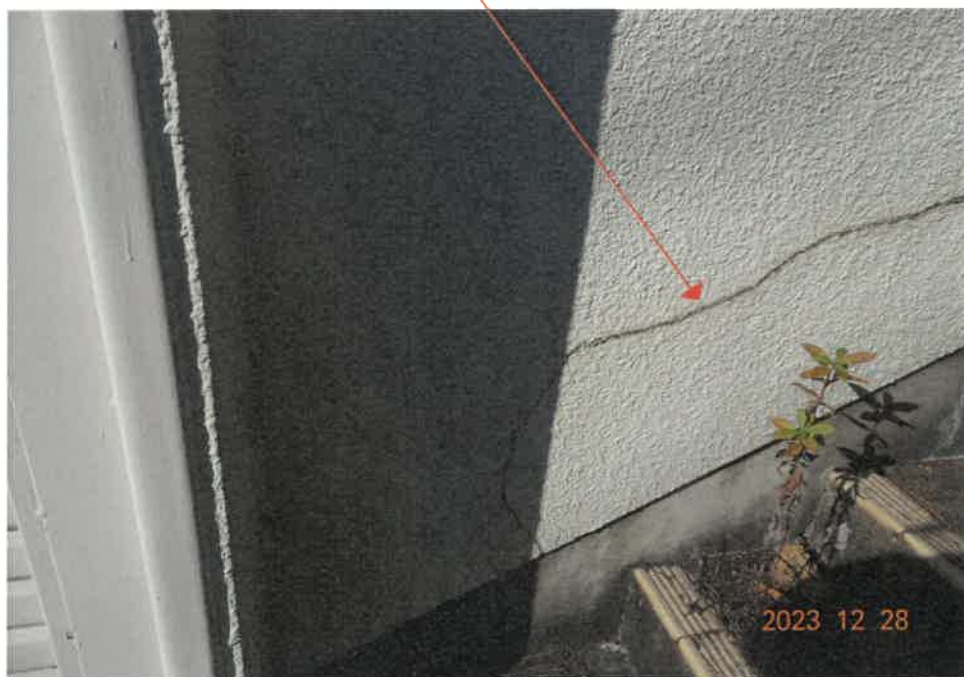
⑩ (コンクリート塀 クラック)
