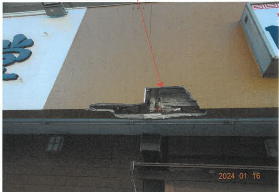
⑪ (物件 9 外壁損傷箇所)
