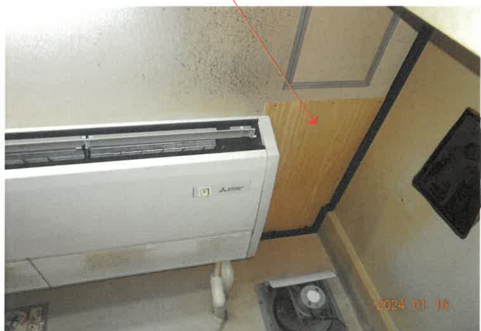
(物件9 店舗4 ⑫ 雨漏り修復箇所)
