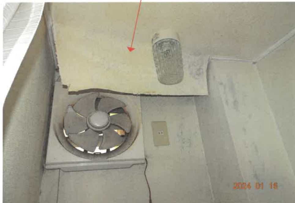
(物件 9 店舗 5 ②① 天井損傷箇所)
