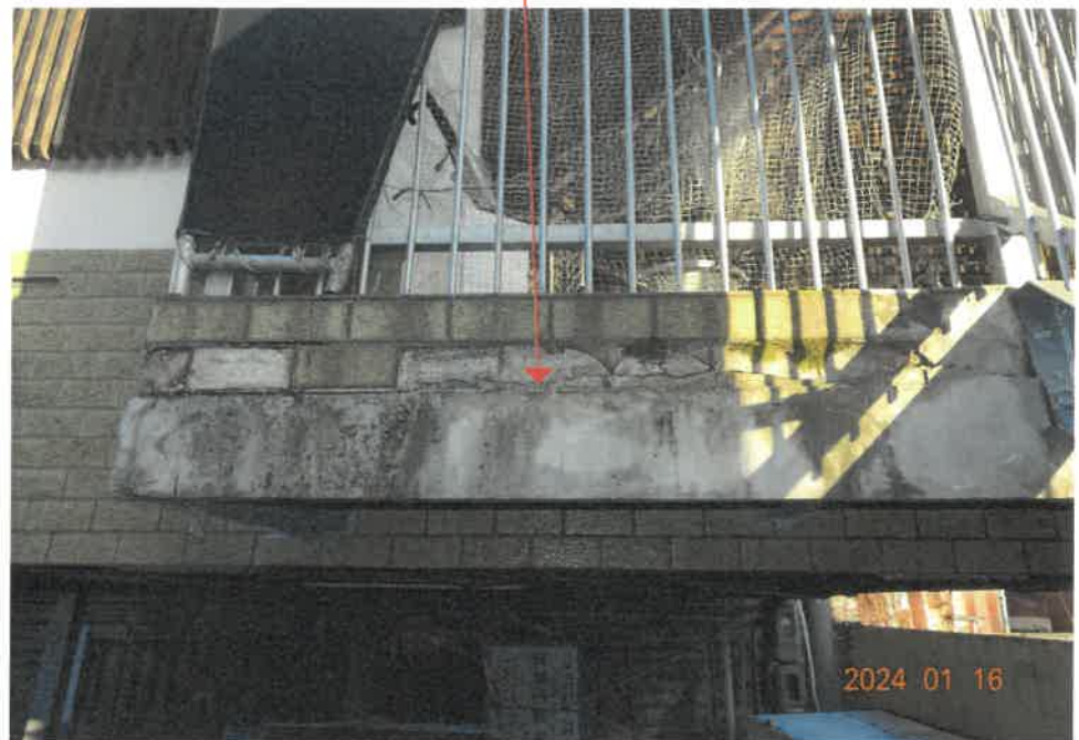
⑤ (物件 8 外壁損傷箇所)
