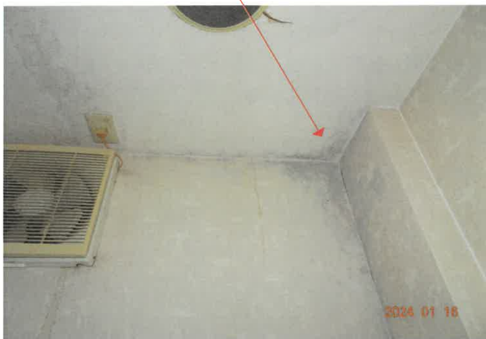
(物件 9 店舗 9 ②② 天井のシミ)
