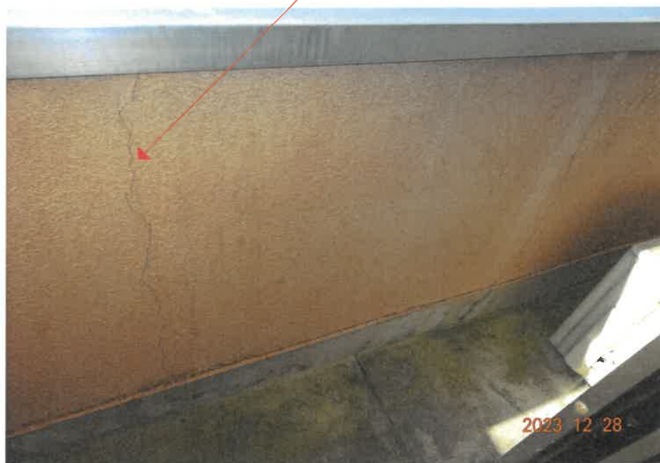
③① (205号室 ベランダ外壁クラック)
