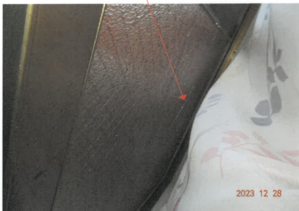
③④ (301号室 窓ガラスひび割れ箇所)
