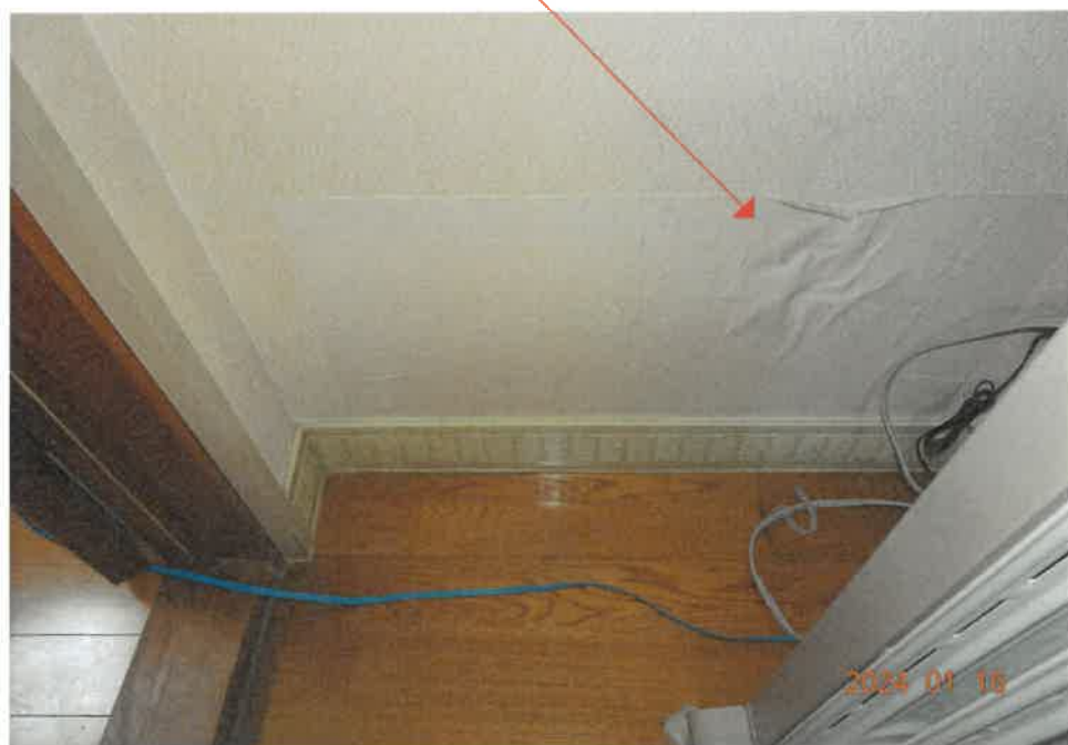
㊦ (203号室 DK内壁 破損箇所)
