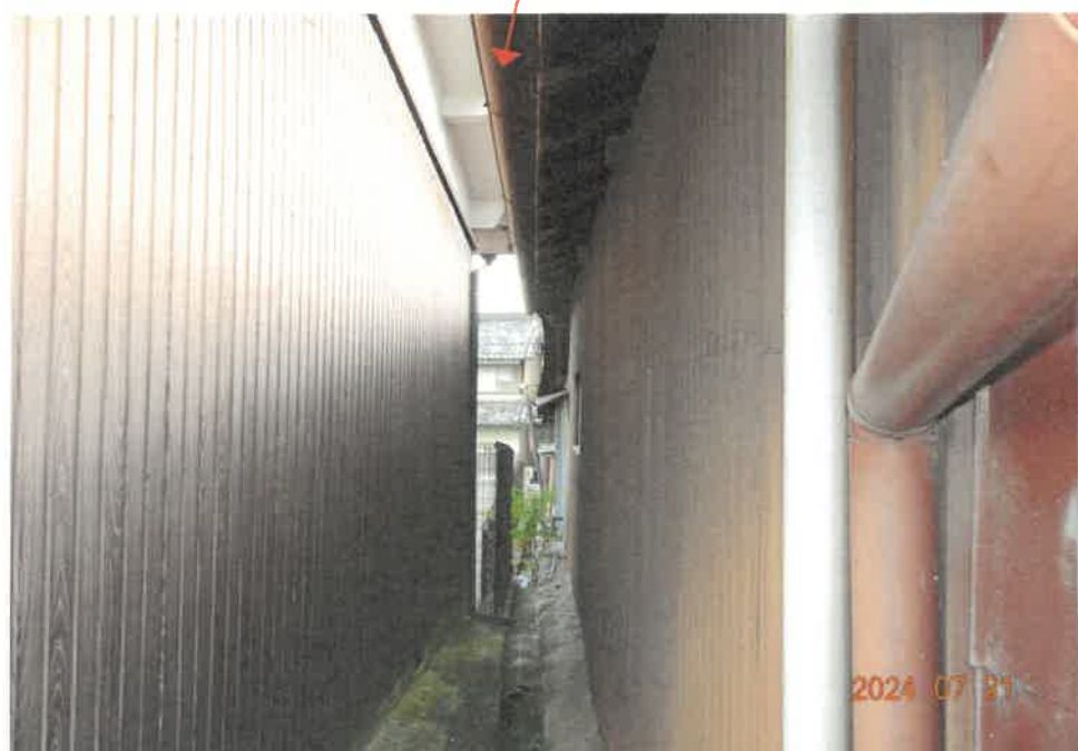
⑭ (越境の可能性がある附属建物東側の樋)
