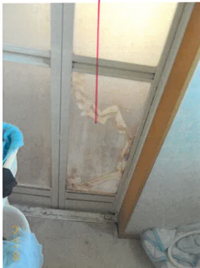
ガラスが一部割れる
