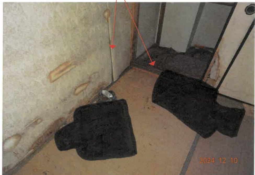
⑭ (地下1階東側和室 内壁及び押入付近床の損傷箇所)
