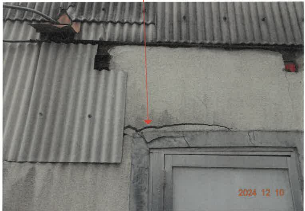
⑪ (外壁クラック)
