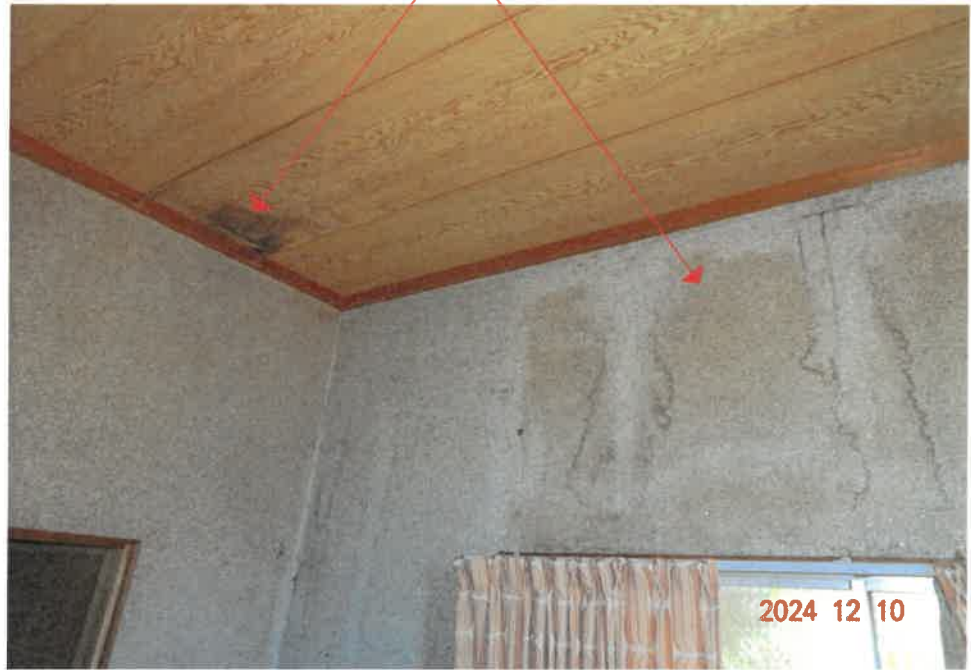
⑬ (地下1階西側和室 天井及び内壁シミ)
