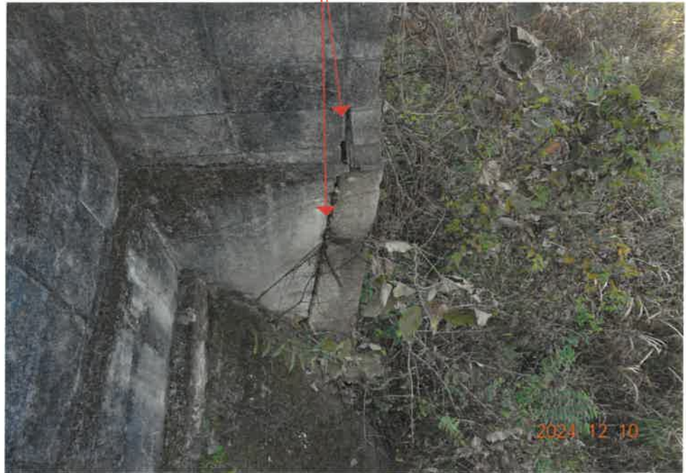
⑨ (コンクリート基礎及びブロックの亀裂)
