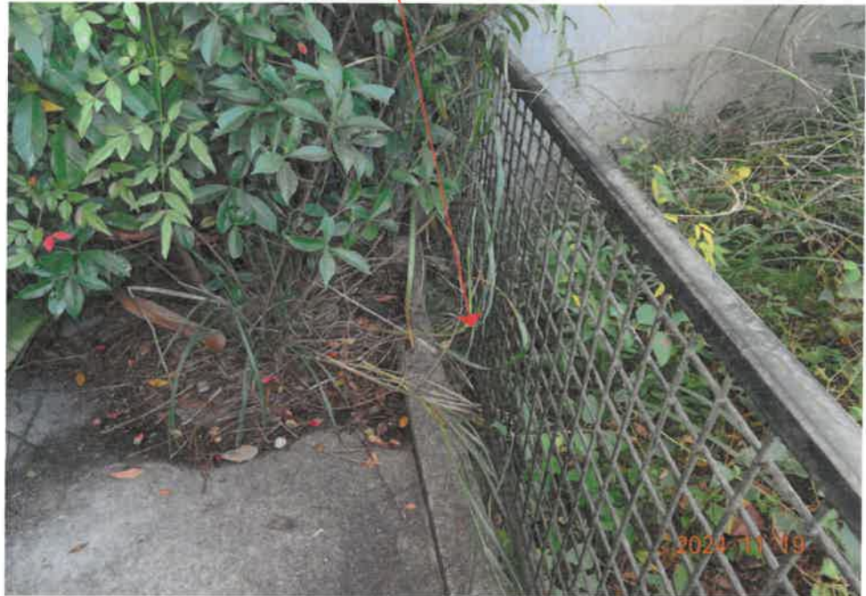
⑦ (根元部分が外れているフェンス)
