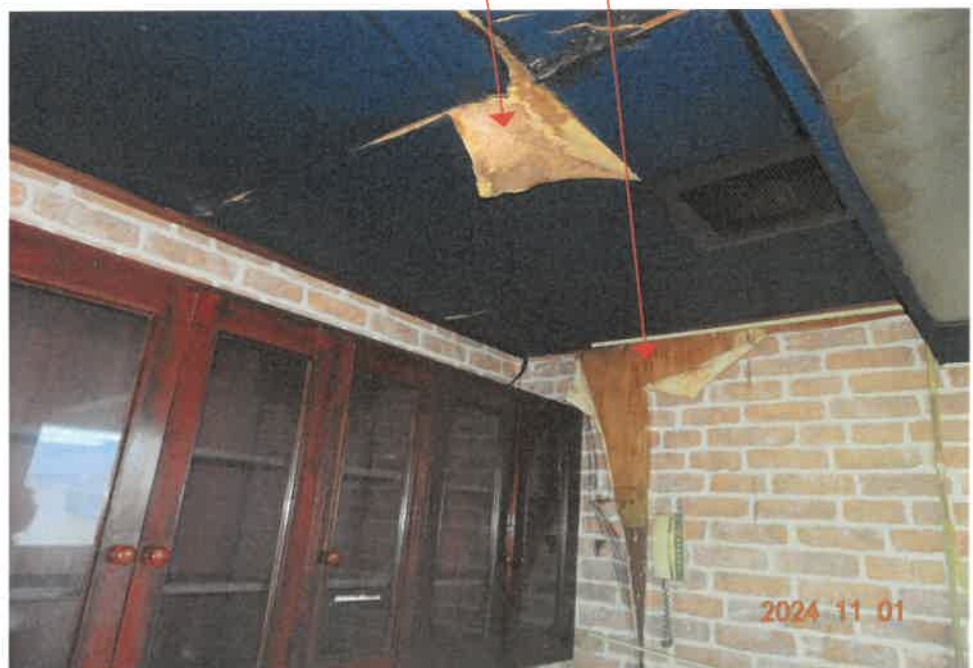
⑩ (2階店舗部分のカウンター 天井・内壁損傷箇所)
