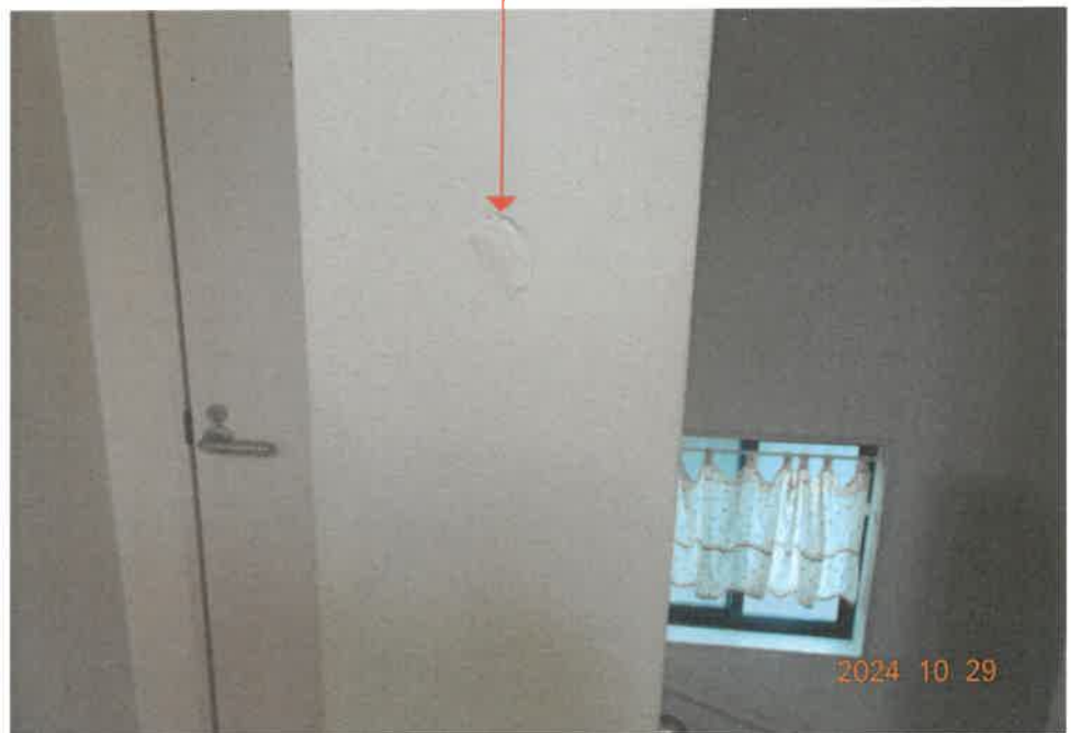
⑫ (2階リビング 内壁損傷箇所)
