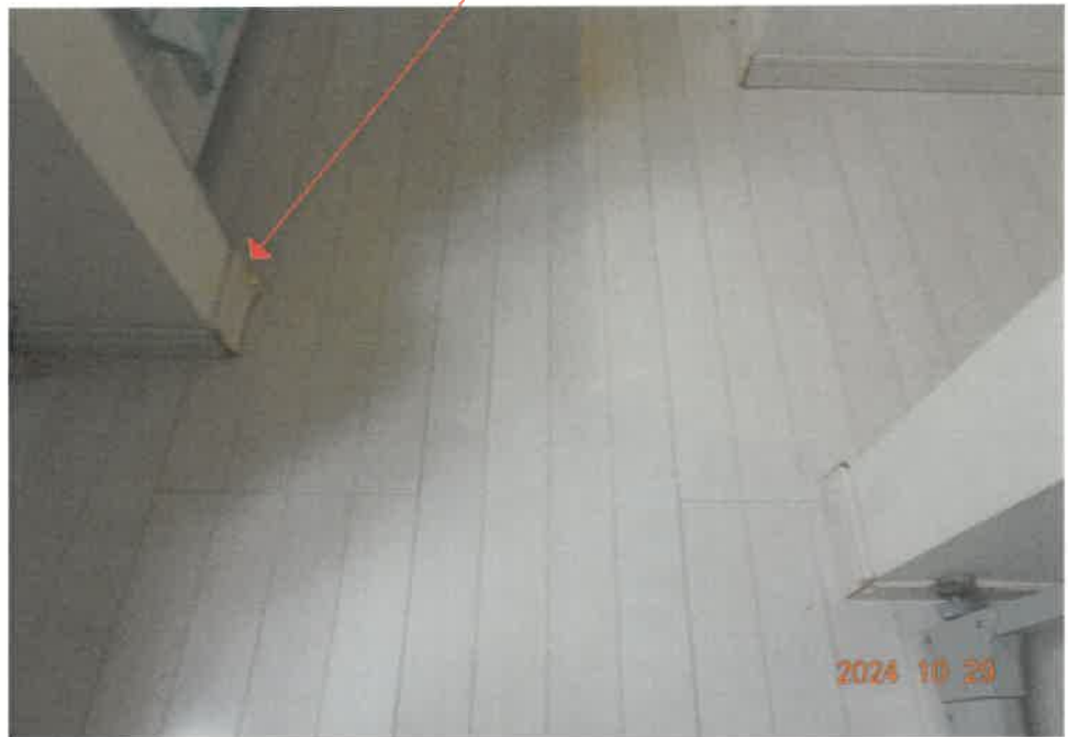
⑪ (2階キッチン 巾木損傷箇所)
