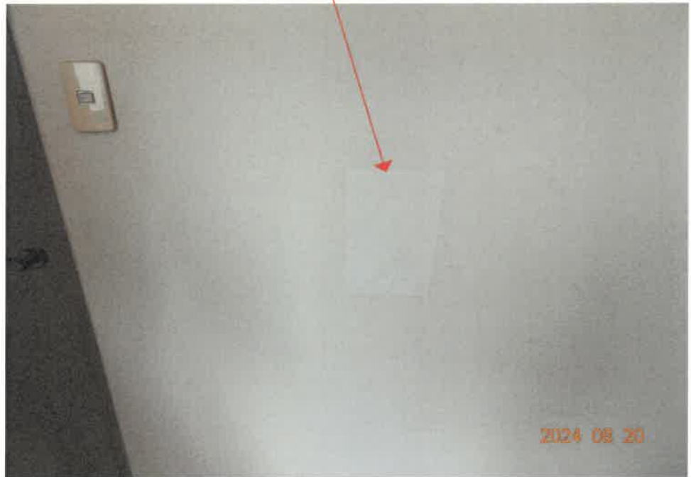
⑬ (2階廊下 内壁破損箇所)
