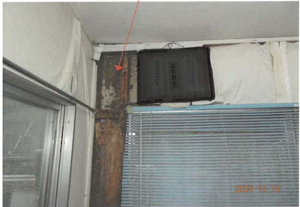
⑪ (物件2附属建物 1階損傷箇所)
