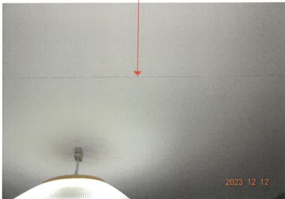
②① (物件3主である建物 2階南西側洋室天井クラック)
