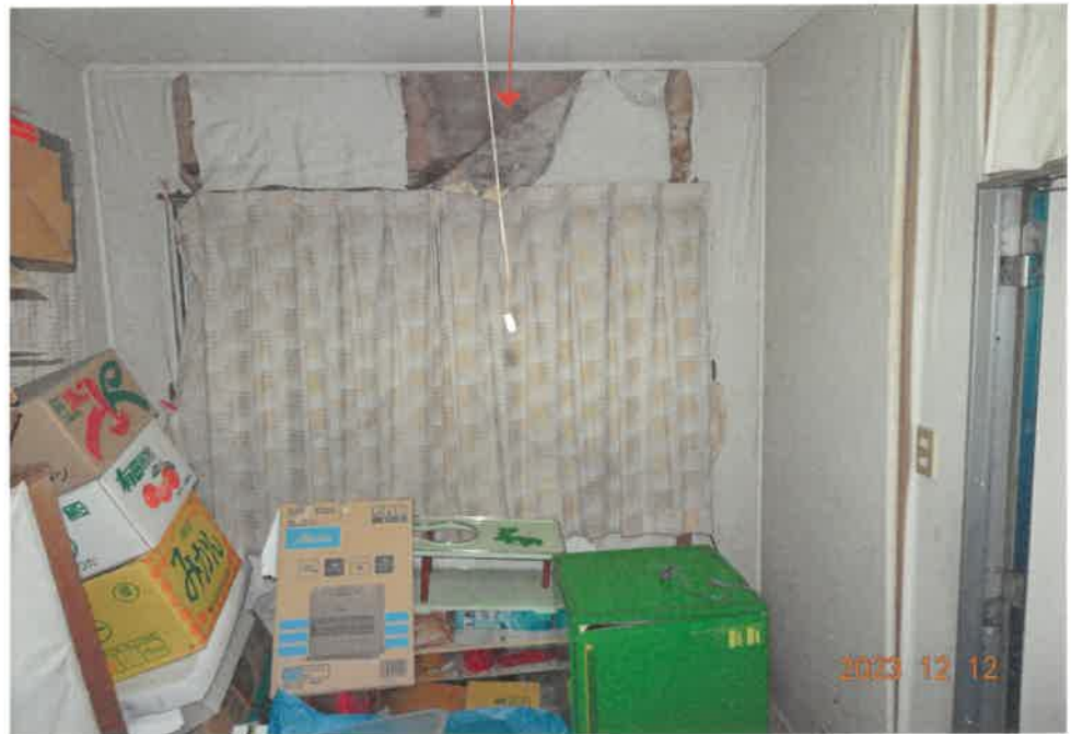
②③ (物件3 附属建物 内壁損傷箇所)
