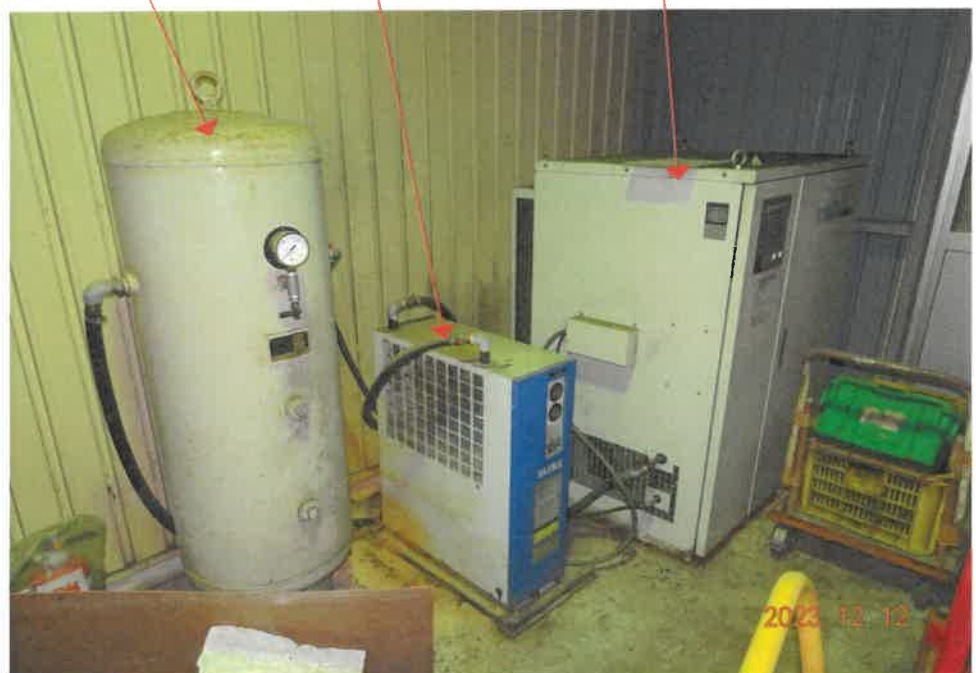
②④ (エアータンク・AIR DRYER・小型空気圧縮機)
