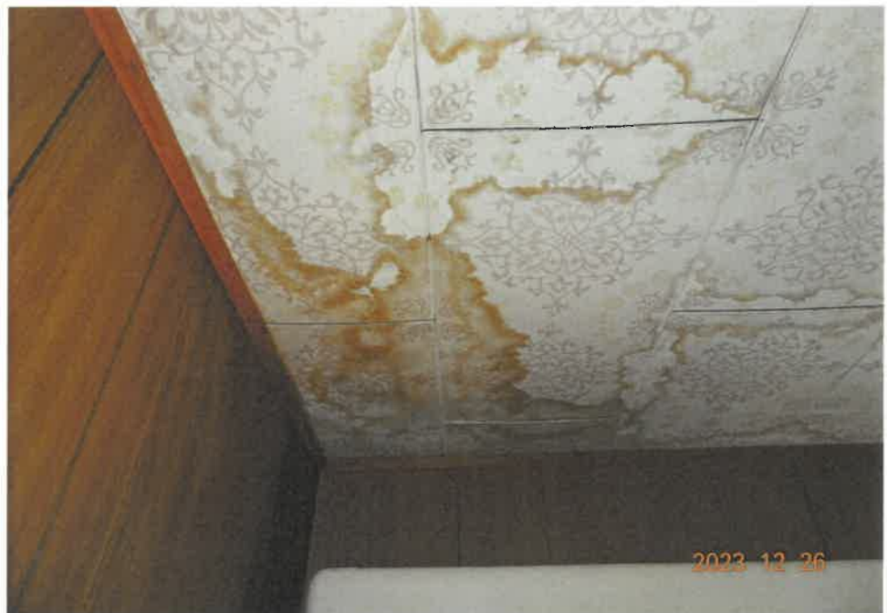
⑧ (1階洋室 天井雨漏り跡)
